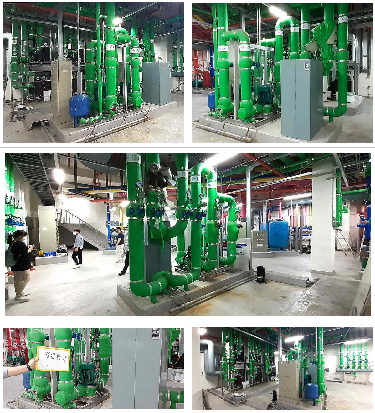
감정 목적물 열교환기 전경
